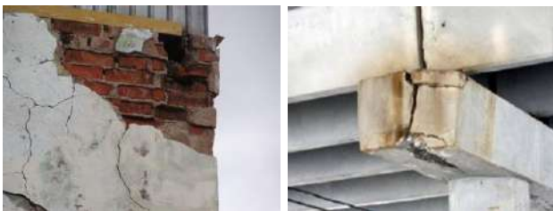
Рис. 2 – Приклади пошкодження опорних елементів
