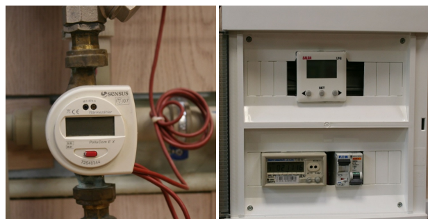
Рис. 19. Счетчики учета: а – тепловой энергии; б – электрической энергии
