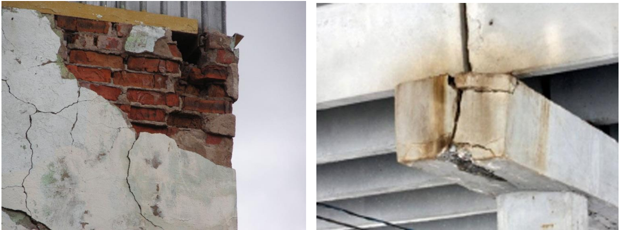
Рисунок 1.3 – Приклади пошкодження опорних елементів
