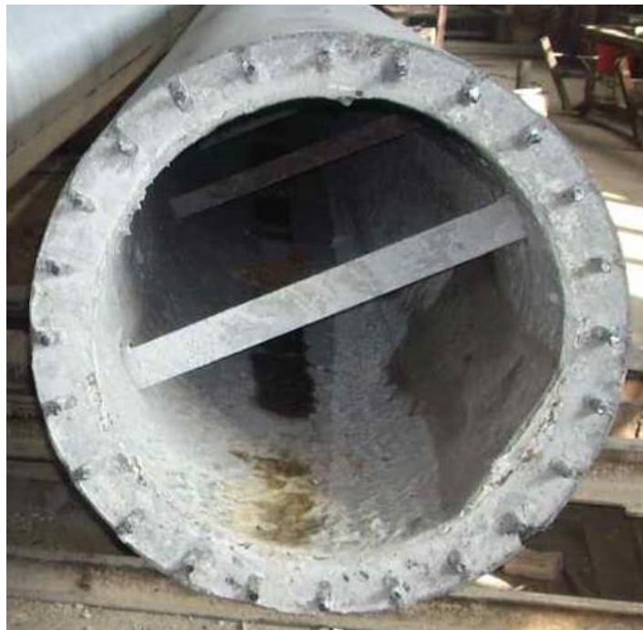
Рисунок 3.2 – Зовнішній вигляд з торця на залізобетонну опору лінії електропостачання із 24 армуючими стрижнями
