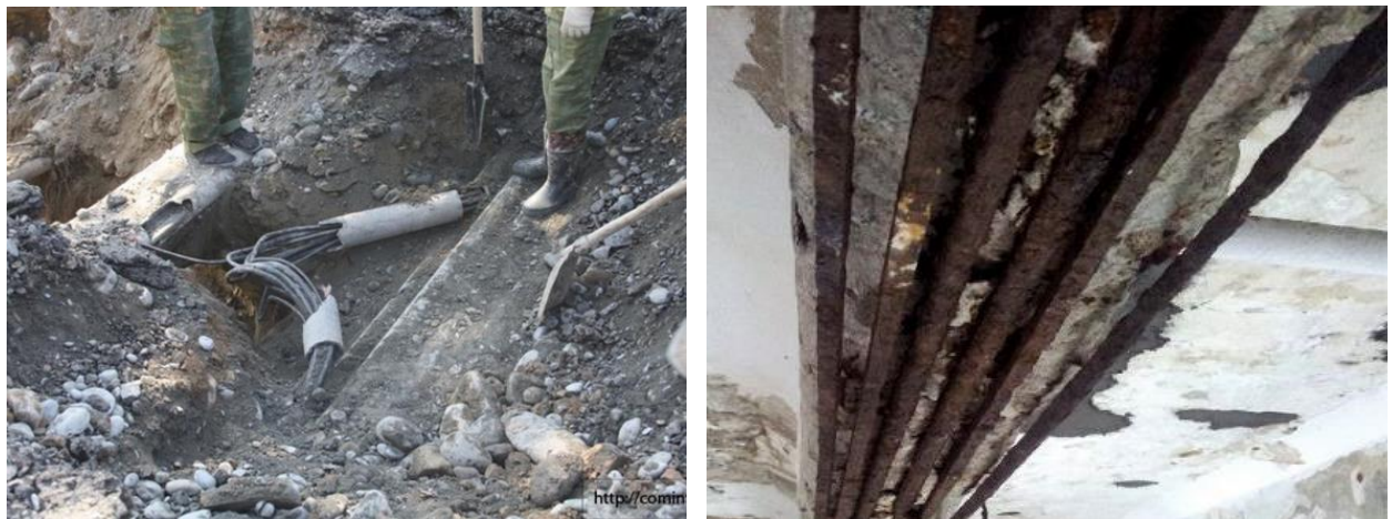
Рисунок 1.4 – Приклади пошкодження комунікацій
