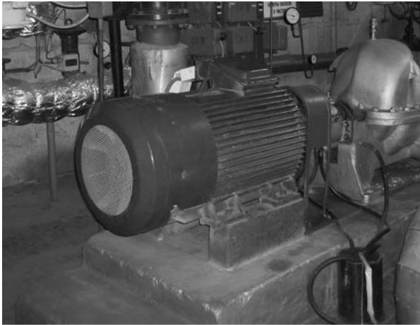
Рис. 1. Зовнішній вигляд асинхронного двигуна мережевого насосу
